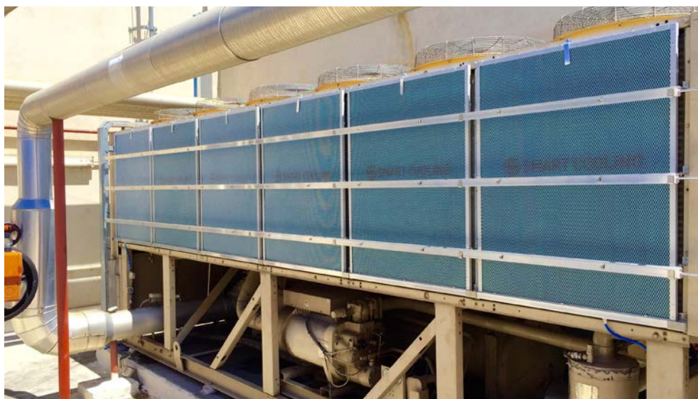
Ilustración 1- Sistema de enfriamiento adiabático Smart Cooling instalado en enfriadora.
